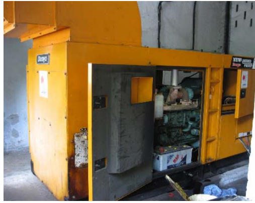
エル・マルーフ病院の発電機。
