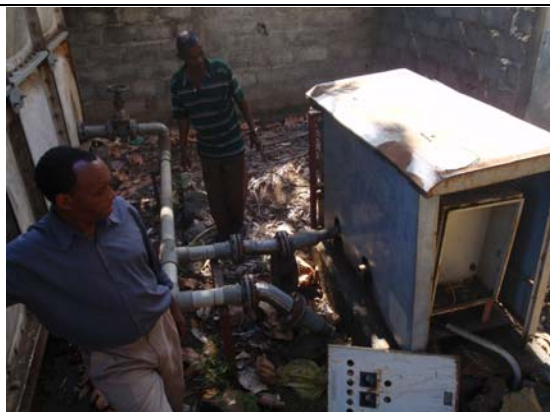
修理不能な国立水産学校内の貯水槽及び送水ポンプ。
