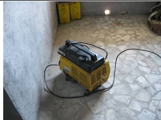
ヘルスポスト内の発電機。燃料が高いのため、ほとんど使われていない。
