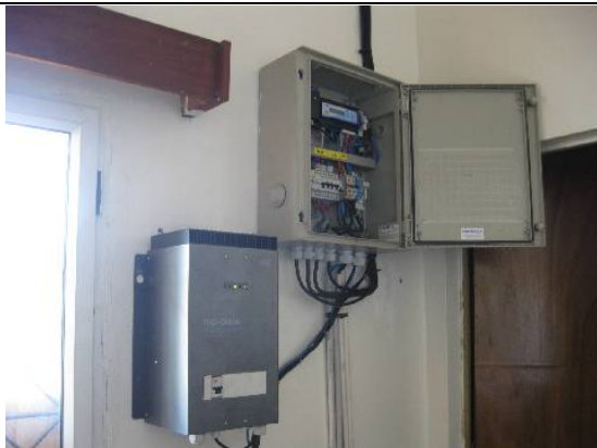
センター建物内の配電盤とレギュレータ。
