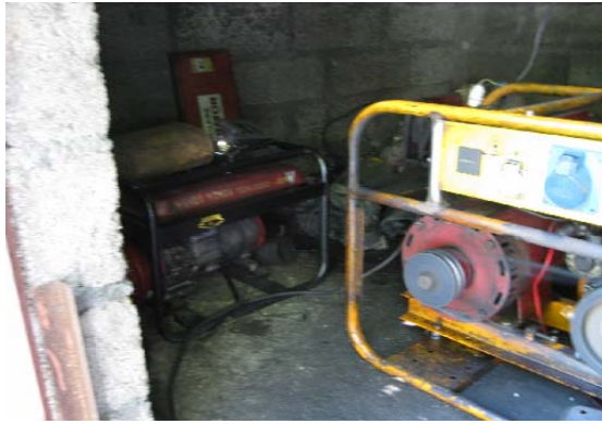
ヘルスセンター内の発電機。一部破損している。
