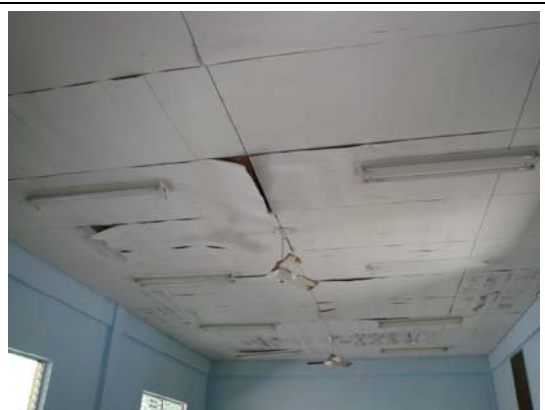
国立水産学校内の会議室の天井の状態。
