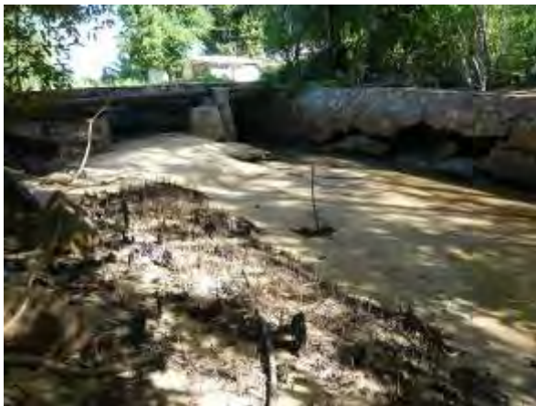
下流側流路右岸の一部破壊された護岸と廃道にかかる橋
