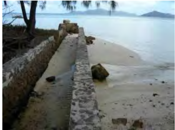
導水路の状況 (導水路壁の基礎が洗掘され水みちとなっている)
