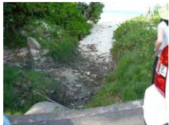
海側流路（砂により閉塞されている）
