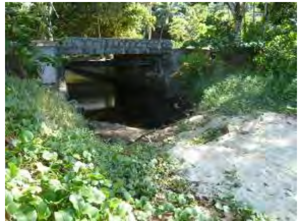
橋下流側の砂の堆積状況
