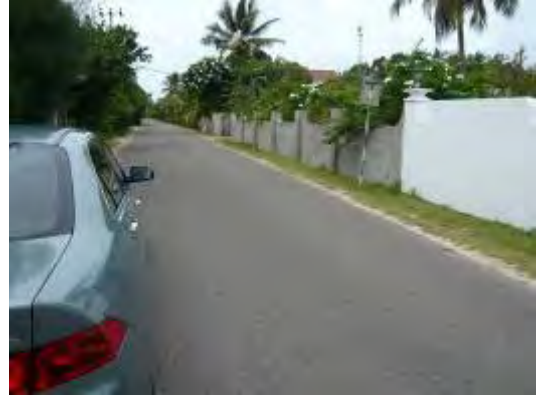
左に同じ（海岸からの越波により砂が道路に溜まる）
