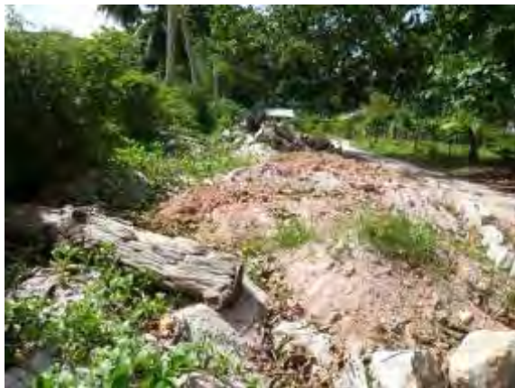
土石により埋立てられた縦排水路 (上の地点の下流側)
