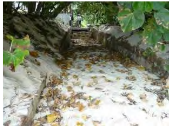
排水路付近の砂溜まり
