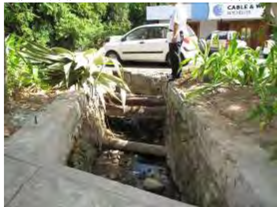
写真 14 ビクトリア市街地の排水路。上水道管路が排水路断面を阻害している。
