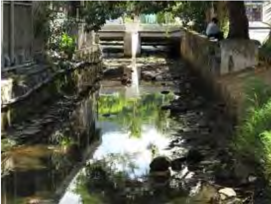
写真 11 ビクトリア市街地の排水路。橋梁により流下断面が阻害されている。
