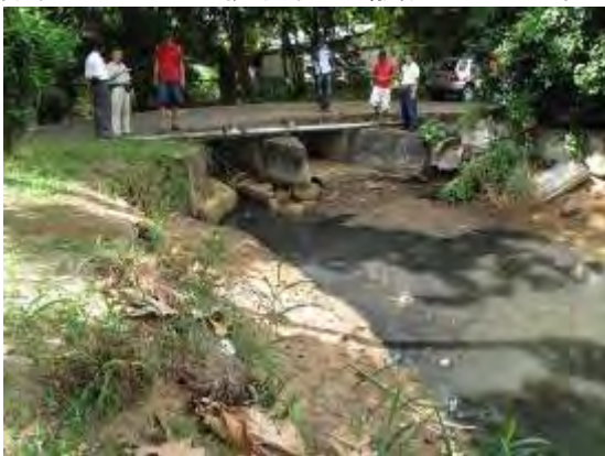
写真 15 マヘ島 Mandarin Estate 付近の河川状況。橋脚が河川断面を阻害している。
