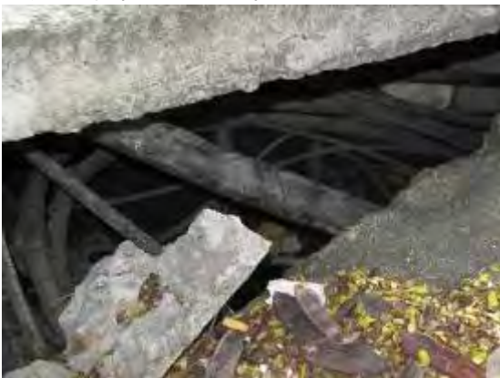
写真 13 ビクトリア市街地の排水路。公共施設の管路やケーブルが排水路内に敷設されている。
