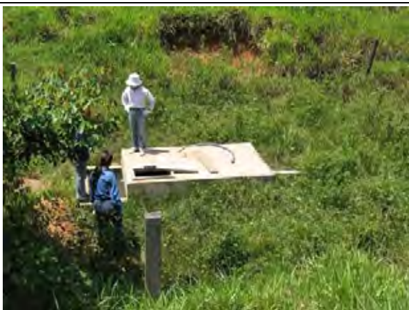
写-31 小川から取水する簡易水道水源 ーNueba Triumfo ーここからポンプで下のタンクに送水する
