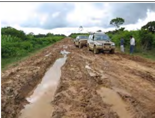
写-19 泥濘状に轍掘れした道路 -R3、Trinidad 西方、Bermeo 付近 -スタックしやすく雨季は通行困難
