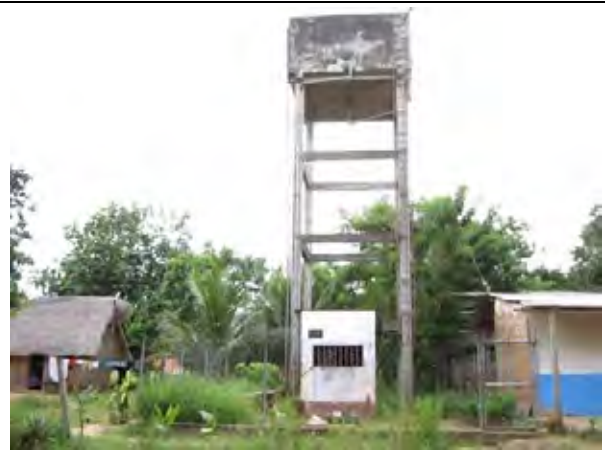
写-14 高架タンクの一般的な形式 ーSachojere ー下は井戸と水中モーター（稼働中）
