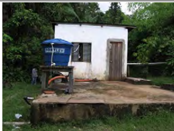
写-28 Puerto Rico の簡易水道施設 —下は貯水槽、後方はポンプ小屋、手前は塩素投入タンク
