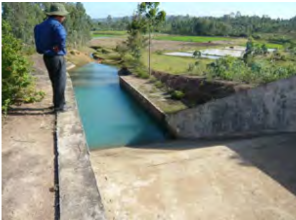
Phung Hoang 貯水池（決壊後修復）
