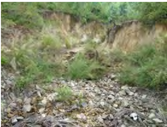
水叩き及び下流水路河岸の侵食
