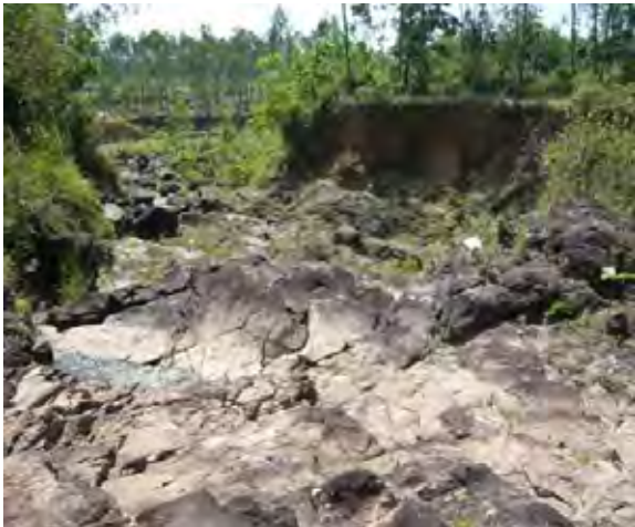
シュート部右岸河岸及び下流左岸の浸食
