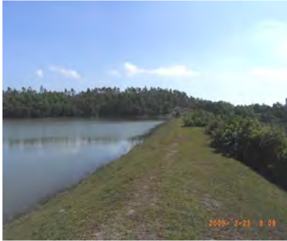
堤体下流側は灌木に覆われている。
