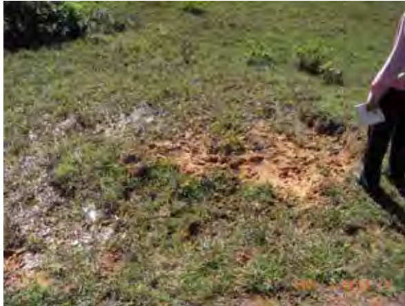
多量の漏水が堤体から浸出・流下しており、堤体材が緩んでいる。
