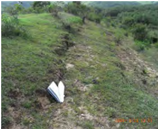
堤体下流側法面の不陸。
