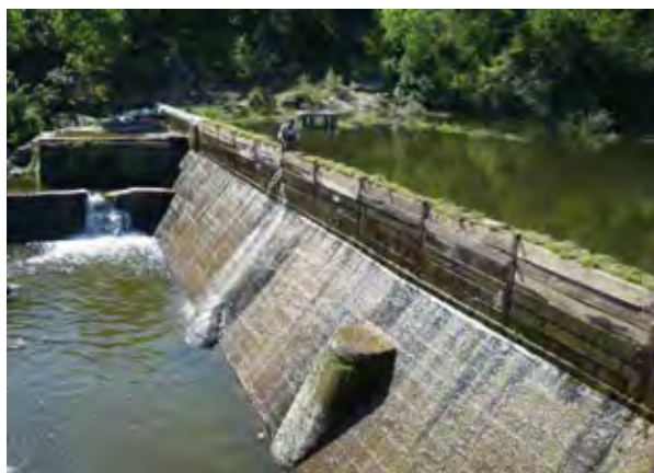
貯水容量確保のため、塞き上げられた洪水吐。流下断面の重大な阻害行為が黙認されている。(Tri Binh 貯水池)
