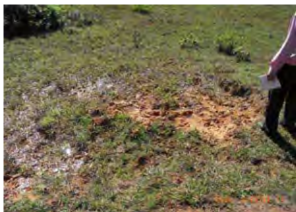
多量の漏水が堤体から浸出・流下し、堤体材が緩んでいる。漏水量は大きく、法尻では小川のような状態になっている。(An Hoi 貯水池)
