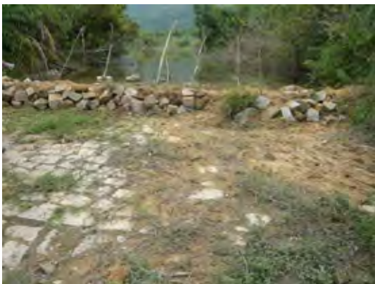
洪水吐越流部土石による嵩上げ
