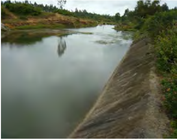
洪水吐角落し用杵（杵の高さは流入部の天端付近までである）。
