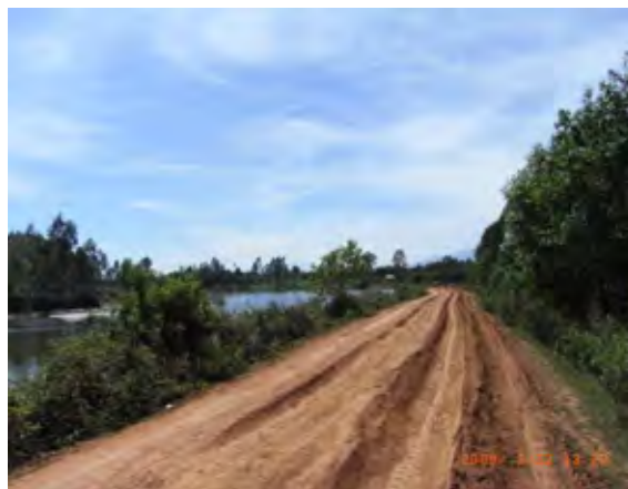
堤体が主要道路として利用されており、不陸が激しい。
