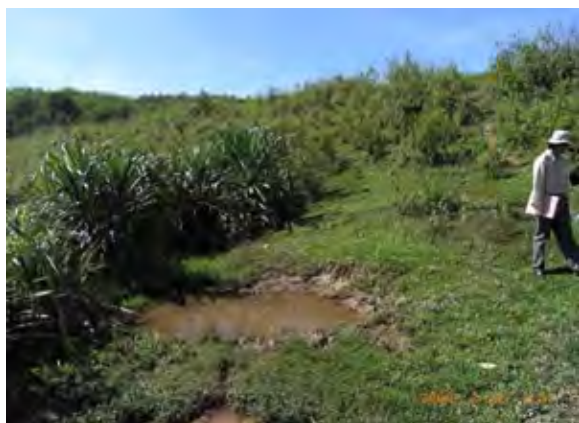
堤体下流側の漏水による水溜りがある。
