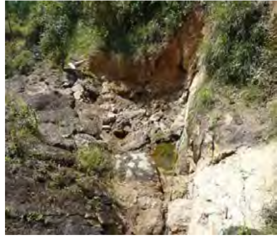
シュート部右岸河岸の浸食
