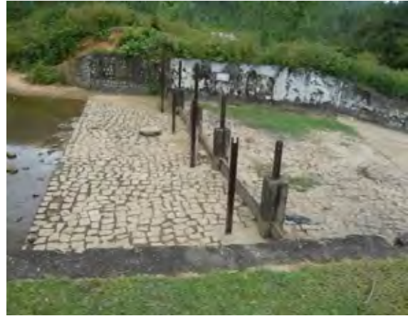
接続水路（水路左岸側に浸食あり）。
