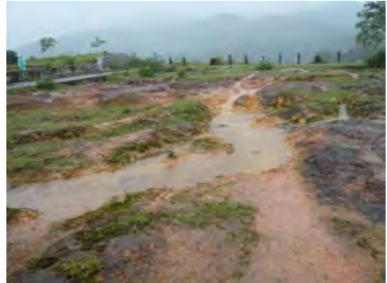
洪水吐流下部（土水路で底面の浸食が激しい）。
