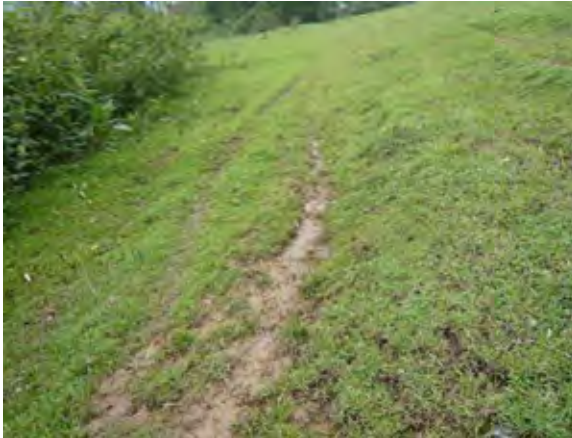
家畜の侵入により法面が不陸となっている。
