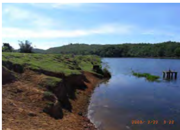
放牧牛の度重なる踏みつけにより堤体上流側が大きく削られている。(同左)
