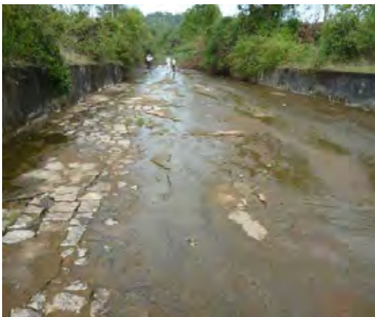
シュート部老朽化状況
