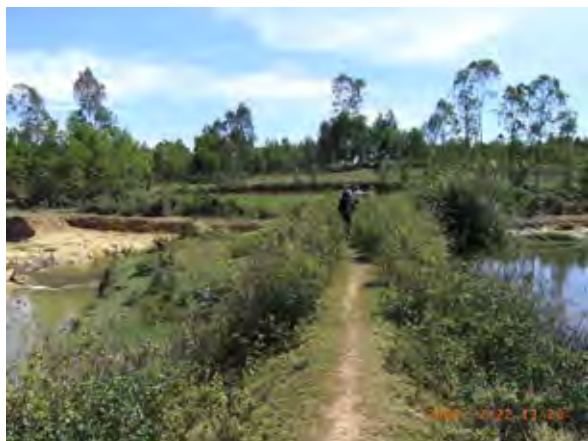
下流側堤体の一部は天端幅が 1m 以下で堤体断面も小さい。
