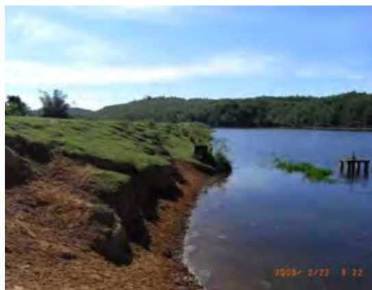
放牧牛の踏みつけにより堤体上流側が大きく削られている。
