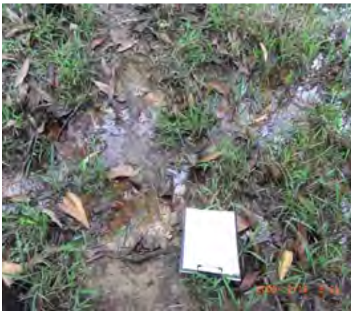
堤体下流部法尻での漏水状況。
