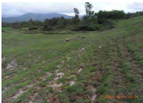
堤体の裏法の広い範囲から漏水が見られ、堤体の変形も生じている。洪水吐の能力が小さく越流の危険が大きい。(Mah Diew 貯水池)
