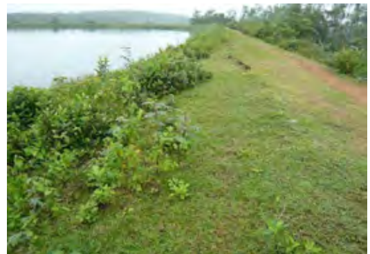
1999年堤頂越流時の土嚢嵩上げ跡（堤頂中央部）。
