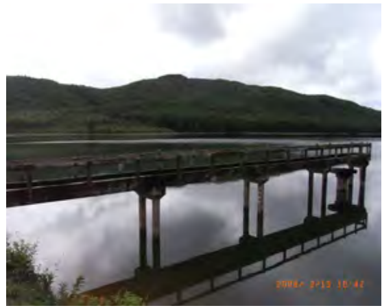
老朽化した取水工。殆ど操作不能。
