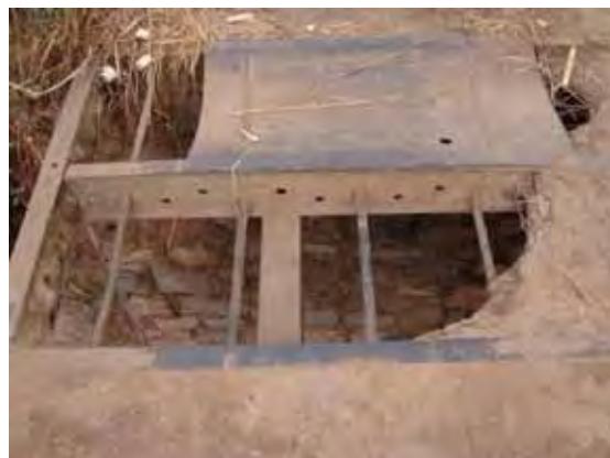
改修前は大きな穴があった
