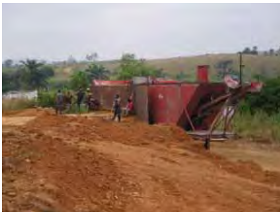
コンクリートプラント
