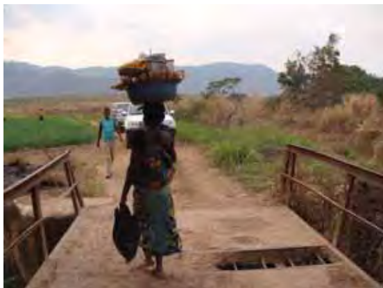
路面が剥落して車の通行に難があった橋
