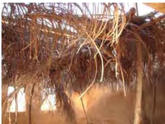
改修前は屋根が剥がれていた箇所もあった
