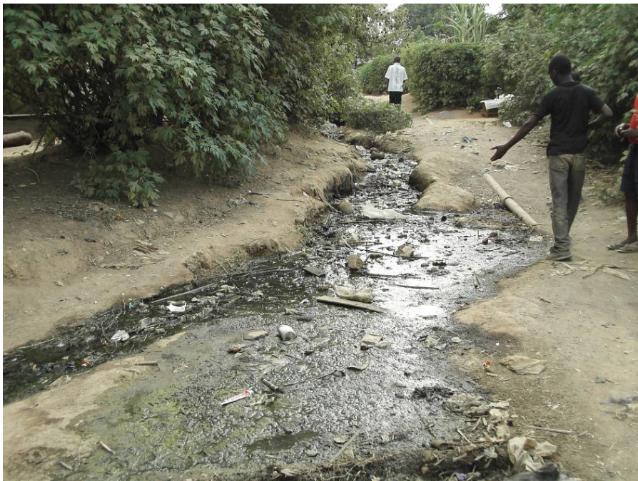
下水管が壊れ、汚水が流れている（ンドラ郡）
