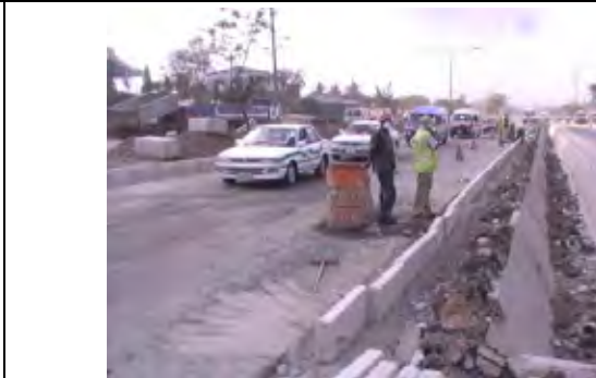
EU 無償による都市幹線道路整備事業 (ネルゾンマンデラ道路での縁石敷設状況)
