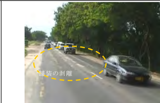
既存道路の混雑状況(6.7km 付近) 路面損傷による渋滞
