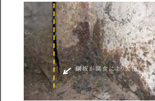
既存ムララクワ橋の健全度判定 (支障部の鋼板が腐食、欠損)
