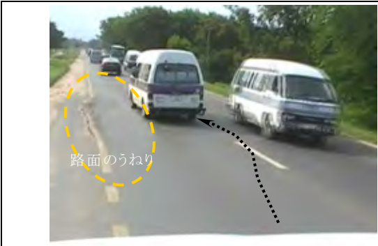
既存道路の混雑状況(5.5km 付近) 路面損傷箇所を迂回する
