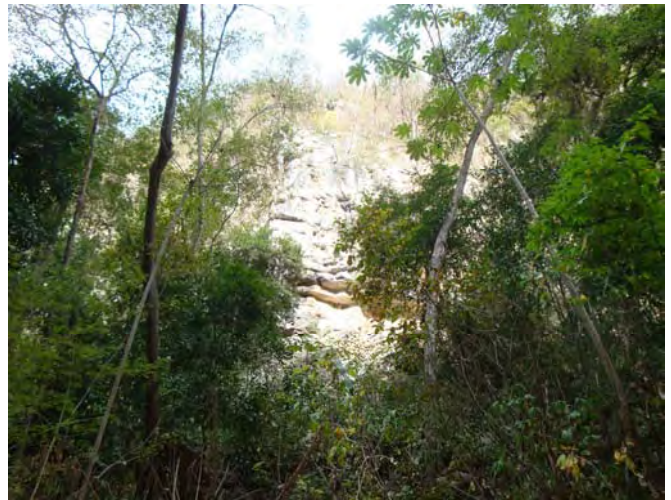
マラリート川左岸断崖崩落箇所
