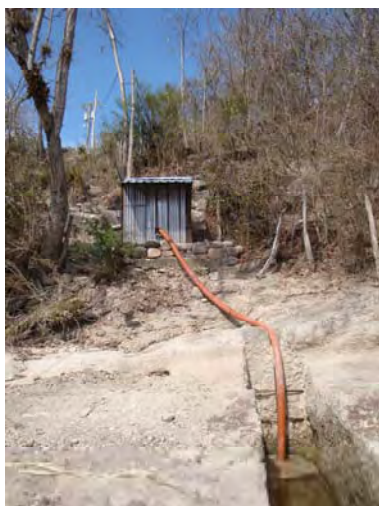
マジエ地区の個人のポンプ場
