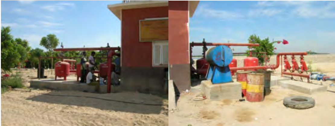
ろ過・送水施設（USAID 援助による施設）
