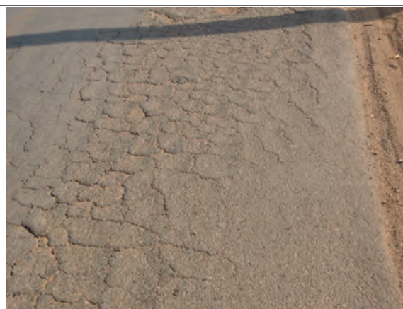
亀甲クラックが進行中
