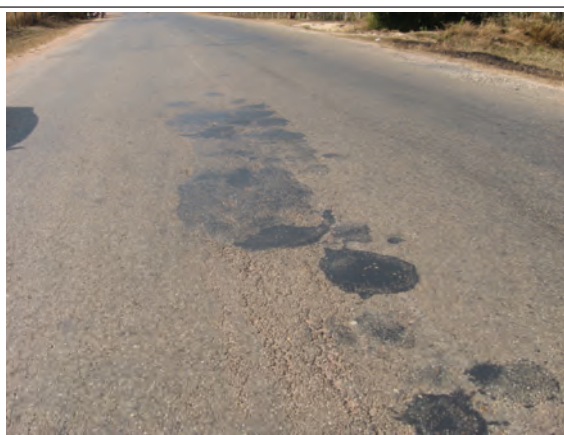
舗装の損傷部を充填のみ行った悪い補修事例：損傷部周辺を含めた補修が必要
