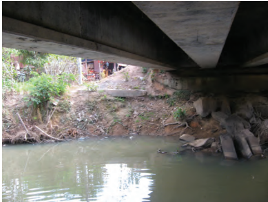
橋台近辺の河川のり面の防護工による洗掘防止が必要
