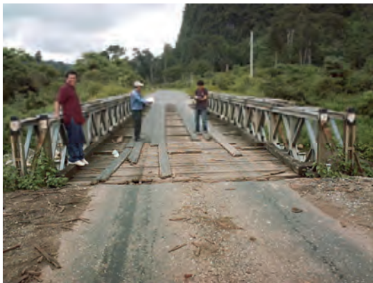
橋梁木製床版の損傷状況
