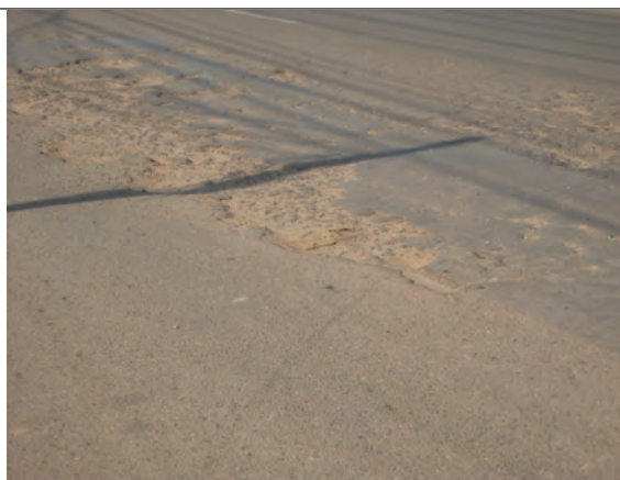
ポットホールが進行中
