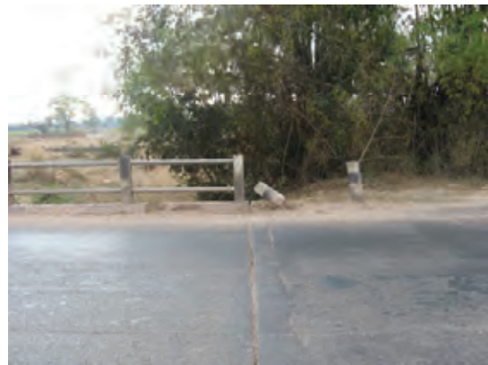
橋面のポスの損傷、伸縮継手の損傷修復跡
