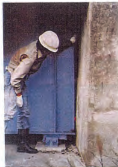
橋台の傾斜損傷例
