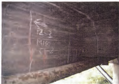
①支間中央部ひびわれ損傷例
