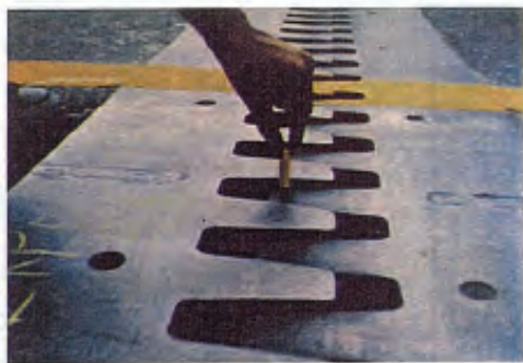
段差損傷事例
