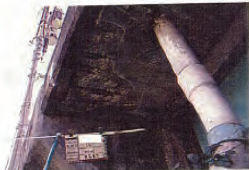
剥離・鉄筋露出損傷例
