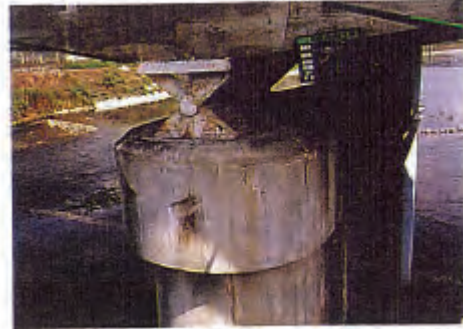
ひびわれ(橋座)損傷例
