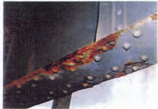
主桁腐食損傷例
