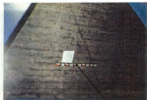
橋軸及び直角方向のひびわれ
