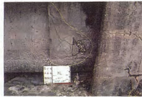
④桁端部ひびわれ損傷例
