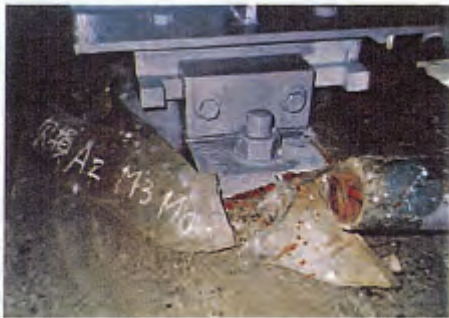
沓座モルタルの損傷例
