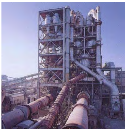
図 2.8.5-2 NSP 付乾式セメントロータリーキルン
