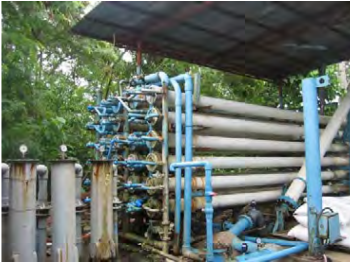
写真-1 マクタンロック社の海水淡水 化用 RO 膜（能力 5,000m 3 /日）
