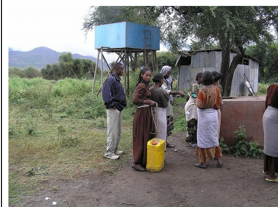
写真-5 (撮影;基本設計調査) : オンスポット施設 (井戸、配水池、発電機室がコンパクトにまとまった施設)
