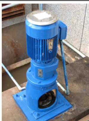
ギア損傷のため急速攪拌機 （ADBが設置）は故障中
