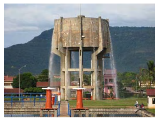
ポンプ運転が手動のため高架タンク もしくは浄水池で頻繁にオーバーフローが 見られる
