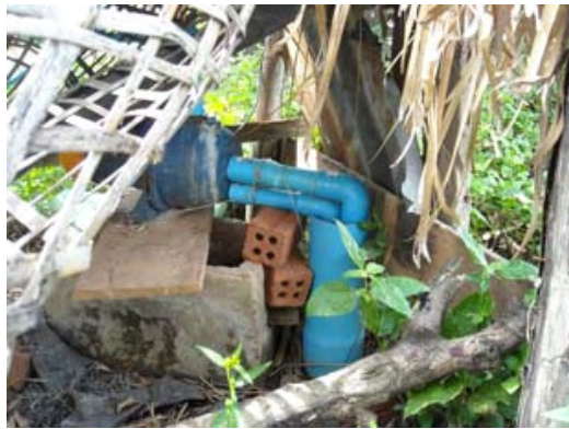
断水対策として手掘りの浅井戸、 掘削井戸を持つ
