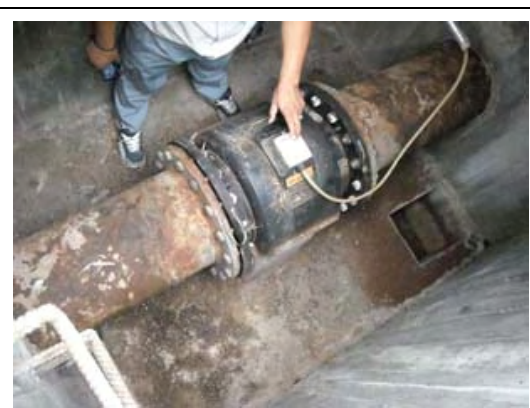
原水導水管に設置されている 電磁式流量計（2基とも故障中）
