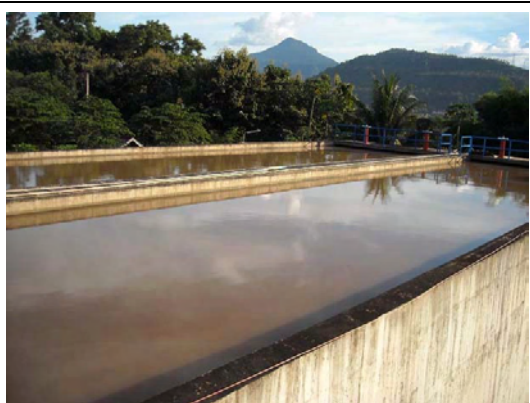
沈砂池：汚濁負荷を軽減するためADBが建設、 平底弁不良のため排泥作業に支障が生じている
