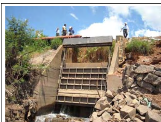
メコン川への汚水放流ゲート 500m直下に浄水場の取水施設がある
