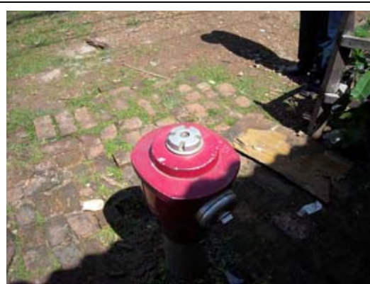
東部地区には NORAD により、消火栓が 3 基設 置されている、中央マーケットに設置されている 数基の消火栓は個人所有
