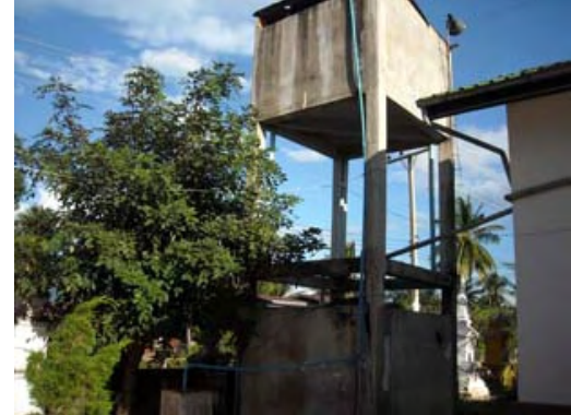
住民（23軒）で資金を募り建設した 部落営水道システム、一日一時間 運転のため、切実な水不足状況（西部地区）
