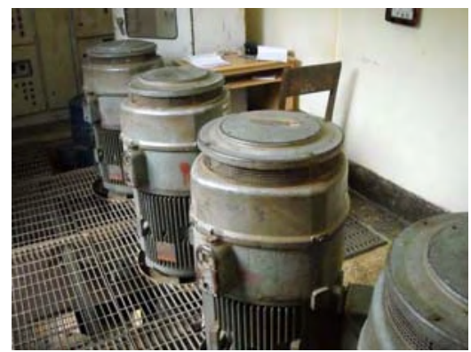
ADB プロジェクトで 1996 年敷設替えされた 取水ポンプ 4 台(モータ部分)
