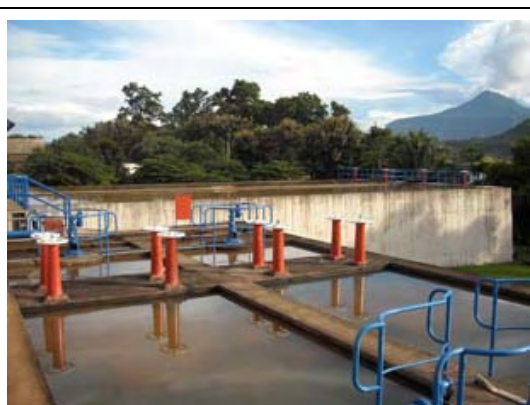
緩速攪拌と沈でん池 （過負荷で運転しているためフロックが流出）
