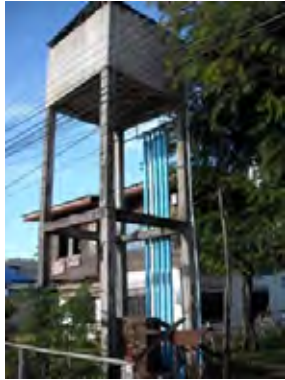
個人経営の水道システム（無許可） 地下水を水源とし120軒が給水を受ける、 12時間給水のため評判悪い（西部地区）
