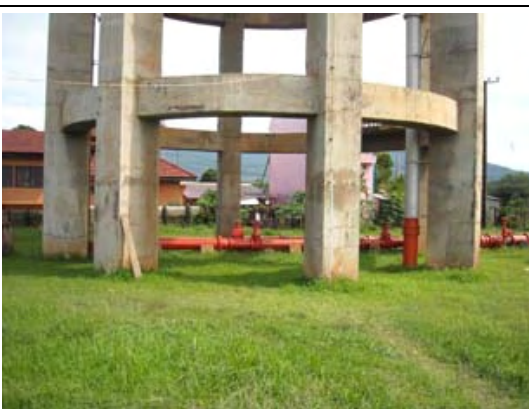
高架タンクの流入管と流出管
