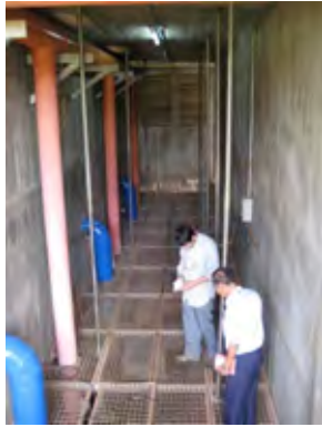
ろ過池管廊部、流出管は浄水池流入渠に直結
