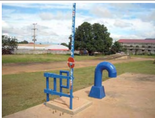
ポンプ自動運転用の水位センサーが 故障したため、NP 職員が配水池人孔部に設置し た水位計、現在はポンプを手動で運転
