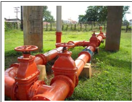
流量計は故障中（青色部分）
