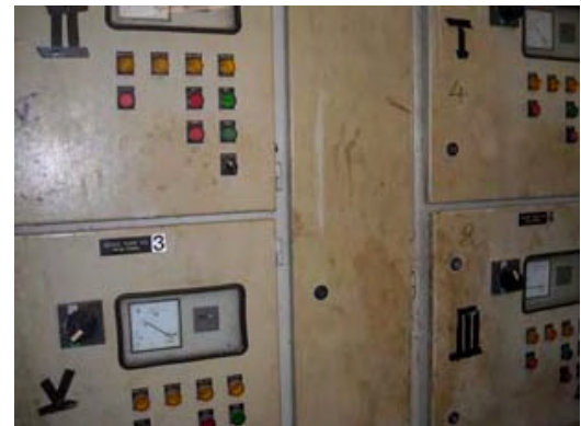
取水ポンプコントロールパネル
