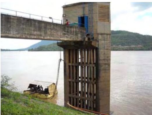
取水塔横には NP パクセが 2005 年設置した フロート式ポンプがあり、現在稼働中
