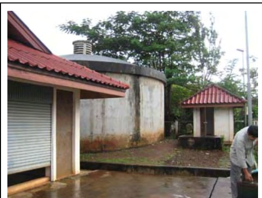
増圧ポンプ場 (地上タンク 300m 3 )
