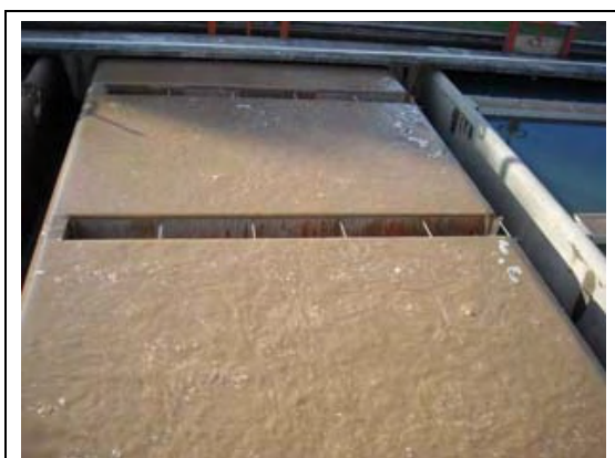
ろ過池逆洗中
