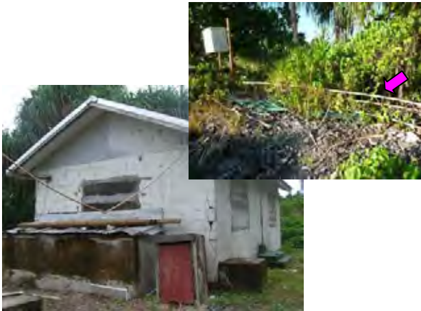
既設中波送信所及び倒壊した中波アンテナ
