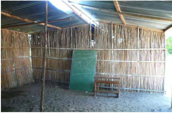
■協力対象校現況:シサノ中学校（ガザ州） 小学校転用中学校。教室不足のため仮設3教室を使用している。
