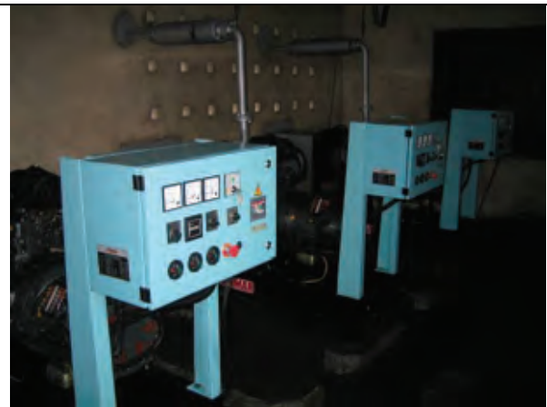
写真 1-4： 既存自家発電機（商用電力の供給 が無い場合、灯台灯器及び宿舍用電力は自家発電 により供給されている。）
