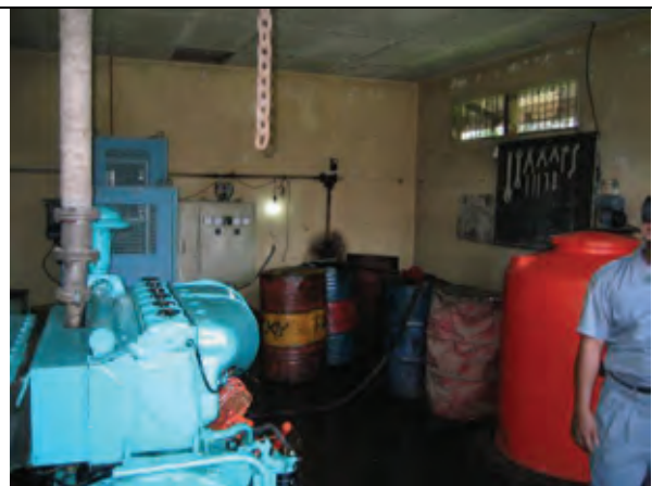
写真 3-4: 自家発電機 (商用電力が供給されているが、電力事情が悪く停電の頻度が高いため、自家発電機が設置されている。)
