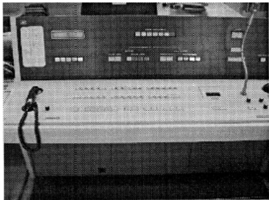
ビンガダムセンター 警報発令装置
