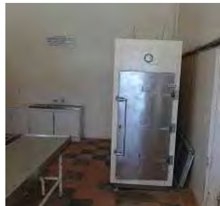
遺体保冷库は故障して修理不能の状態
