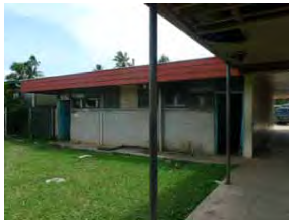
病院霊安室外観 躯体の劣化進捗状況
