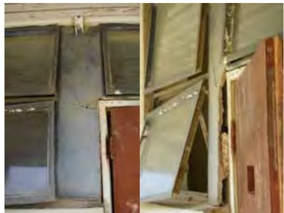
同左 躯体劣化の状態
