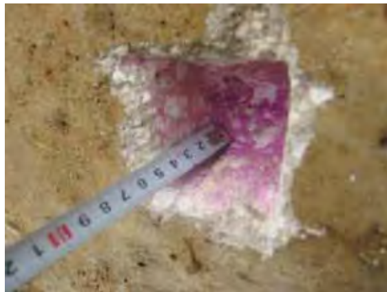
看護学校外壁の中性劣化深度が40mm進行した状態
