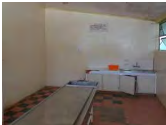
検死室の老朽化の状態
