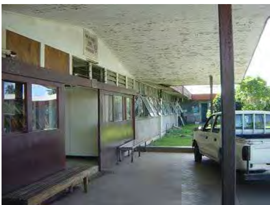
救急・外来・産前検診棟の外観劣化の状況
