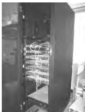
既存 LAN サーバー
