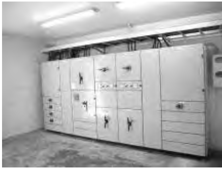
電気室配電盤
