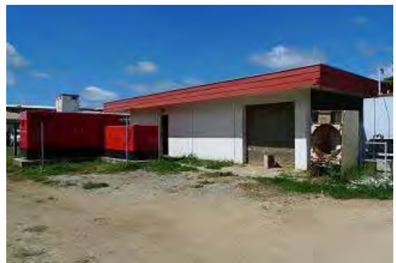
左手に 350kVA の自家発設備。手前 150kVA は故障中
