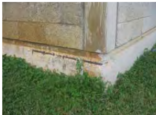
同 棟の構造体の劣化の状況
