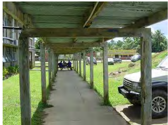
既存渡り廊下の躯体劣化の状態
