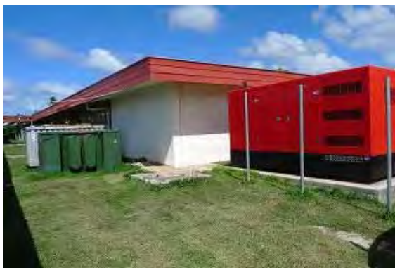
既存電気室外のトランス(左手に2台存在)
