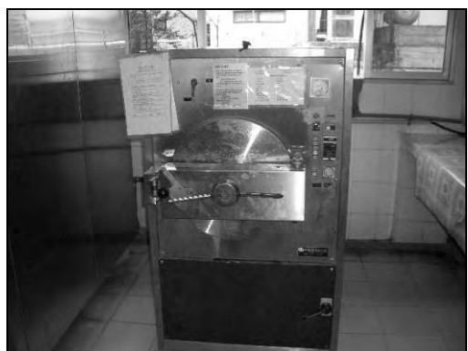
感染管理部門、(I棟2階) 蒸気滅菌装置は4台の滅菌装置を有し ているが、この滅菌装置を更新する。
