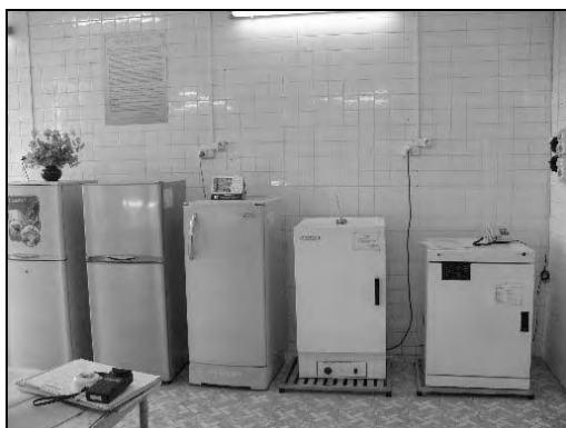
微生物部門、(A棟4階) 右端のCO2恒温槽が故障している。
