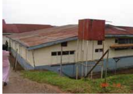
手術棟 1955年に建設された手術棟。外壁、建具に損傷が見られる。またアクセスも悪い。
