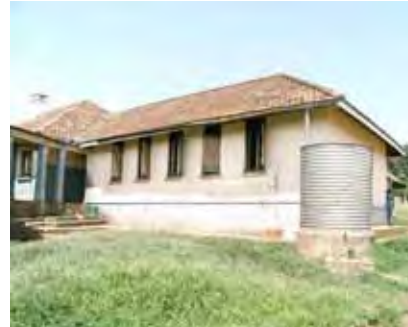
産科棟 建増しを繰り返した産科棟。天井にアスベストが使用されている。
