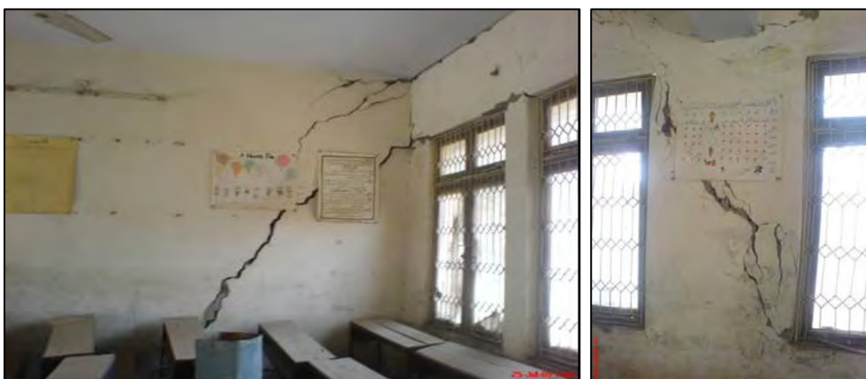
図 6-4 避難所として登録している破損した校舎
