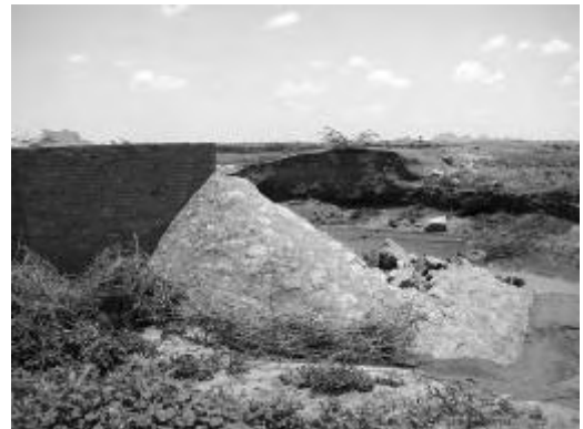
写真 4-23 Wad Shrarifai のダム (堰及び堰周辺の土手が決壊している)
