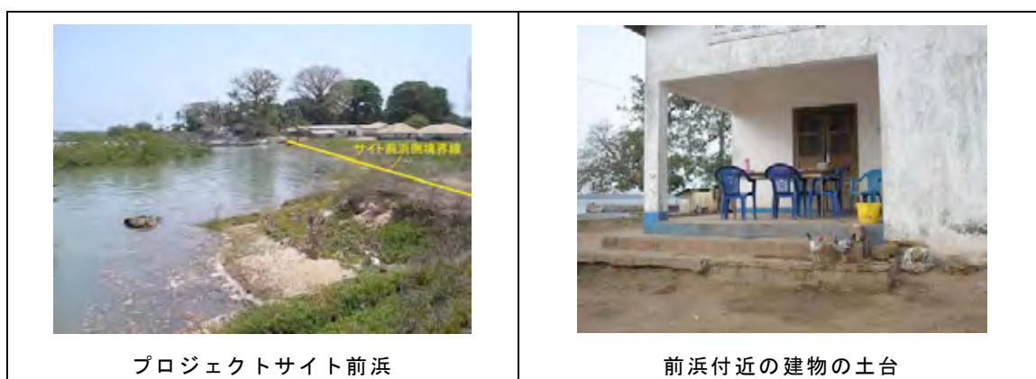
図 2-12 プロジェクトサイト前浜側境界部と前浜付近の建物土台の状況
