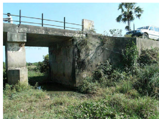
写真-22 : 起点側第 1 スパン。下部工はレンガ積みでひび割れがある。上部工は 4m スパンながら損傷はない。現地盤はコンクリートたたきとなっている。
