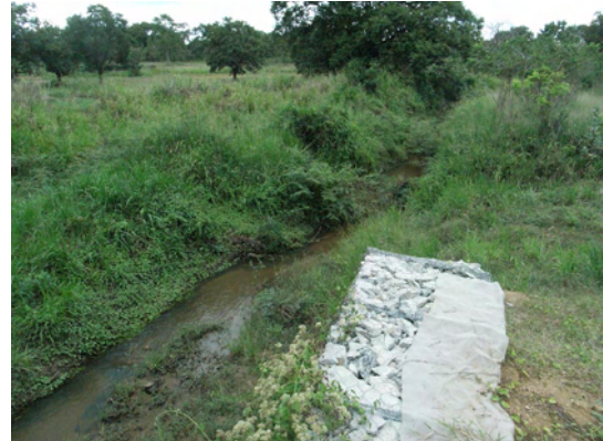
写真-18 : 直交した河川は北側へ。橋台代わりに施工された蛇籠は損傷度合いが小さいため、最近の工事と思われる。
