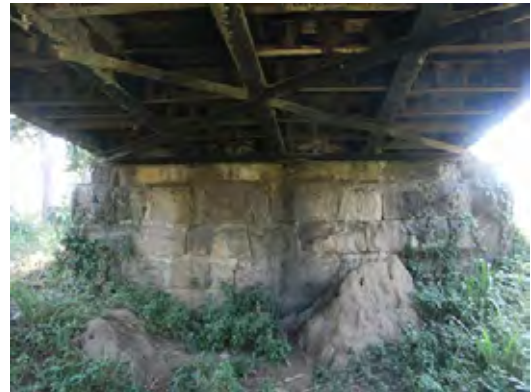
写真-2 : 橋台は石積により建設されている。ひび割れが数箇所見られる。
