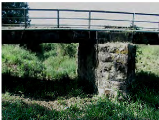
写真-5 : 橋脚は石積により建設されている。桁は下部工に直接乗った状態。
