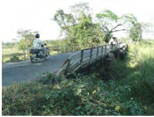
写真-10 : 241/4 見通しの良い区間に架設されている。 橋梁幅員は1車線。
