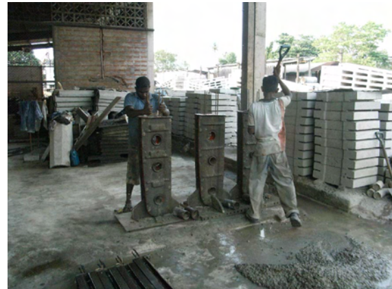
写真-34 : 高欄ポストの製作。コンクリート充填のため人力で揺すっている。
