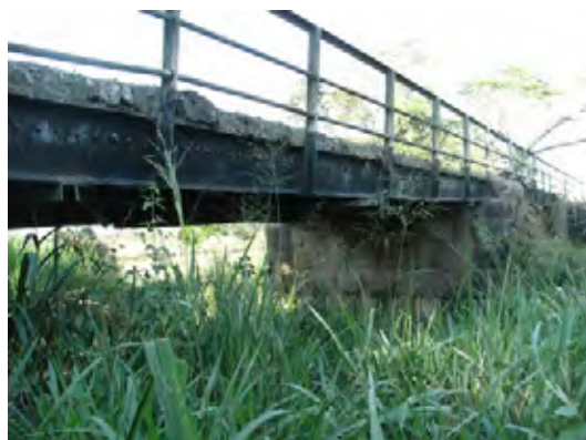
写真-12 : 241/4 H鋼材に腐食が見られる。
