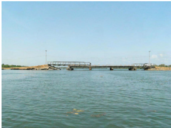
写真-27 : 元々3径間の橋梁であったが、津波により橋台周辺が洗掘され、緊急対応としてベイリー橋が架けられている。
