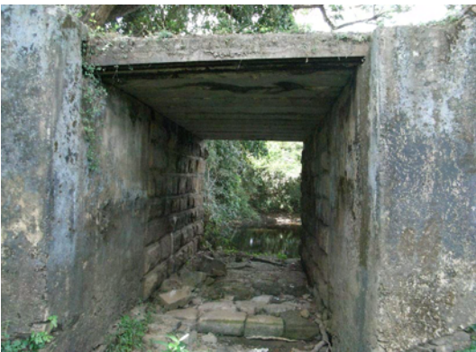
写真-9 : 241/3 カルバート 石積のたたきがあり、南側は石積みをコンクリートで拡幅している。
