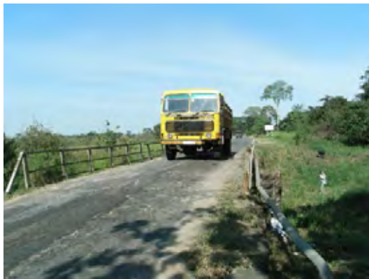
写真-3 : 路面はひび割れ、高欄も破損している。 橋梁幅員は1車線。
