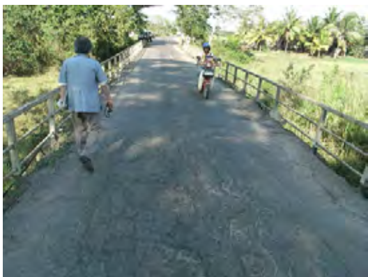
写真-11 : 241/4 舗装がひび割れている。
