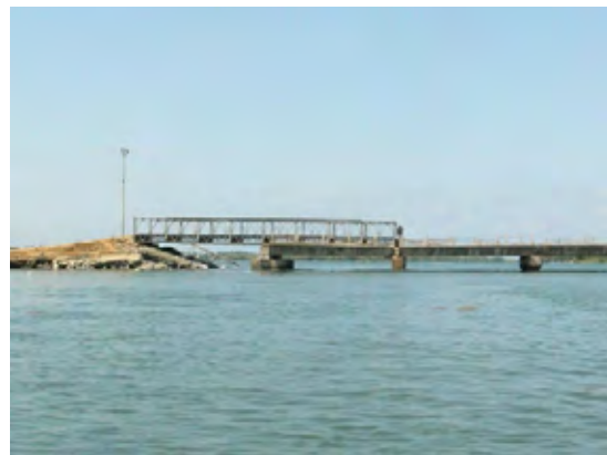
写真-28 : 終点側のベイリー橋の下には、政府軍により戦略的に爆破されたベイリー橋（津波後に架設）が撤去されず残っている。
