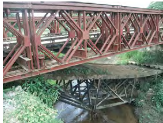
写真-16 : 2 ベイリー橋と落橋したトラス橋。
