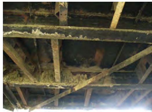
写真-4 : H 鋼桁に腐食あり。また床版から落ちた土砂が部材上に堆積している。
