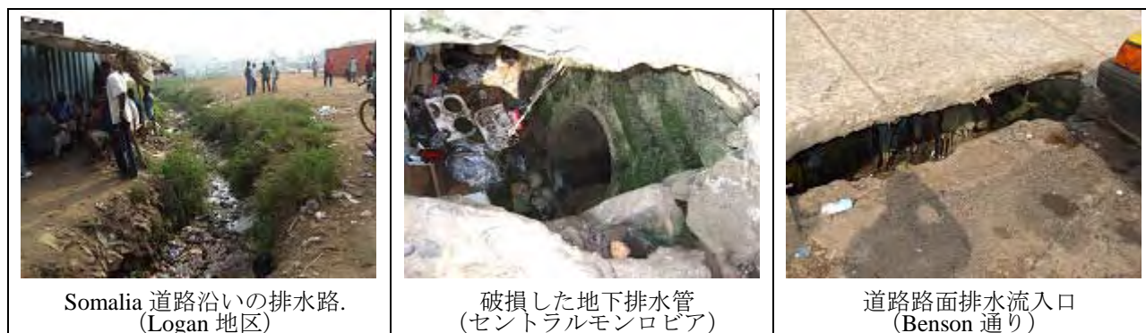
図 2-13 排水施設の現状
