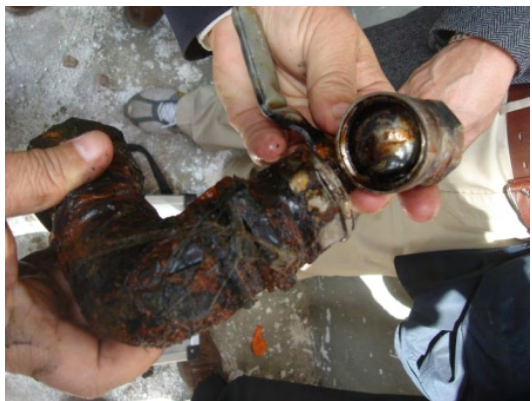
発見された漏水箇所：給水管と配水管の接続箇所が腐食することが原因となって、漏水が発生することが多い。
