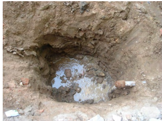
漏水箇所の状況：音聴棒で漏水が疑われた箇所は、給水管に沿って掘削し、漏水箇所を特定する。
