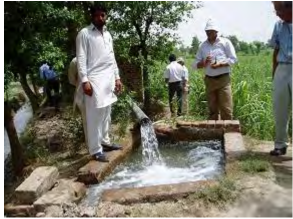
Balochwaranagar のポンプ場
