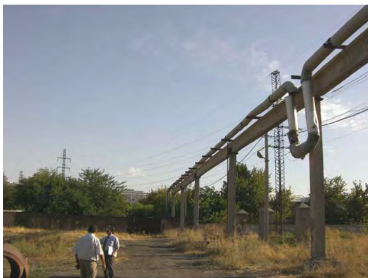
図 1-2-3 蒸気パイプライン
