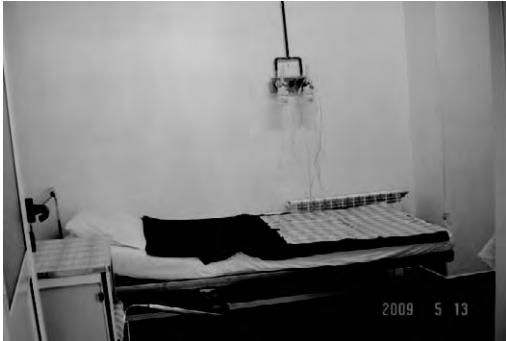
医療ガスが配備されている救急処置室
