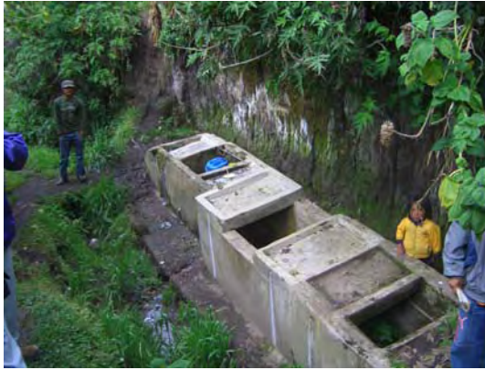
基礎インフラの不備
