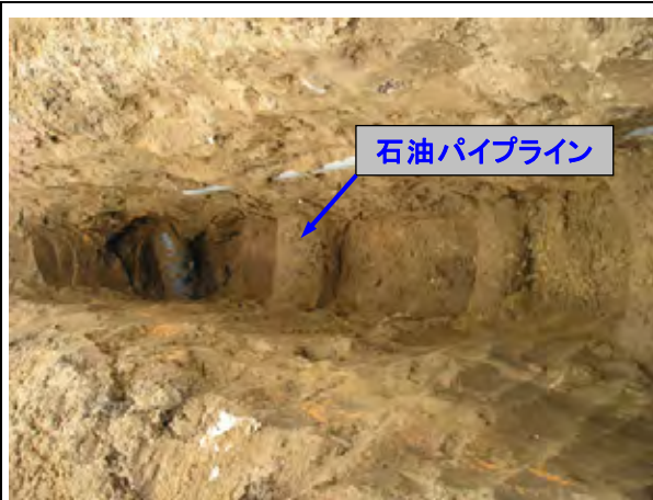
ポワ・ルー通り全沿線に埋設されている石油パイプライン:設計上の工夫で工事の支障にならないようにした。
