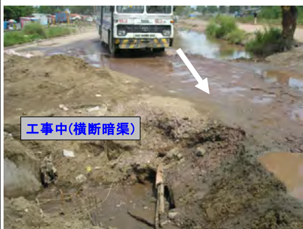
PK9+000 付近の排水不良箇所:激しい雨で道路は冠水する。
