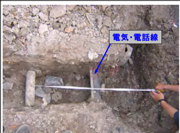
地下埋設支障物件： PK2+250 付近に埋設されていて工事の支障となる電気・電話線埋設状況。
