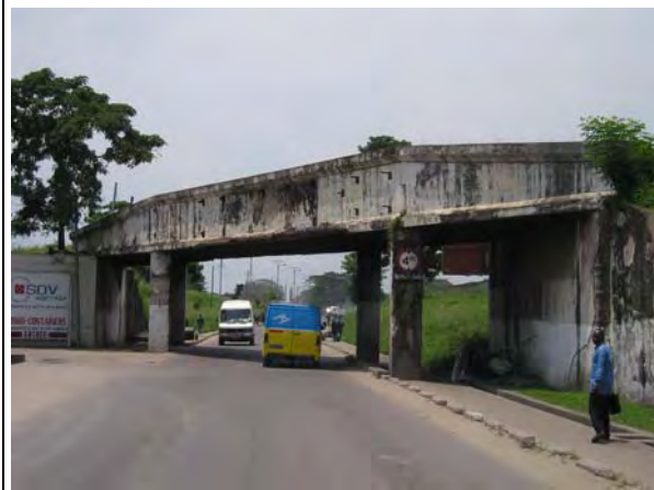
PK2+900 のプロジェクト道路を跨ぐ鉄道橋： 建築限界が 4m で車高の高い大型車の通行は制限される。
