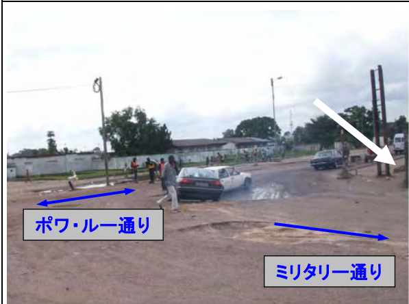
ナバル交差点： 路床が露出し走行が非常に困難な箇所である。
