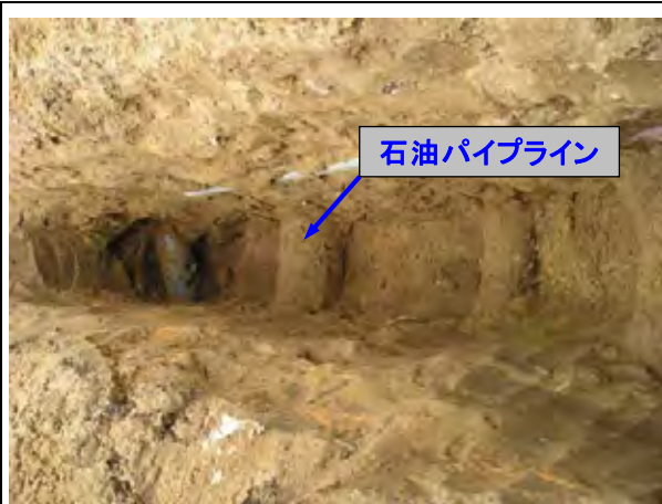
ポワ・ルー通り全沿線に埋設されている石油パイプライン:設計上の工夫で工事の支障にならないようにした。
