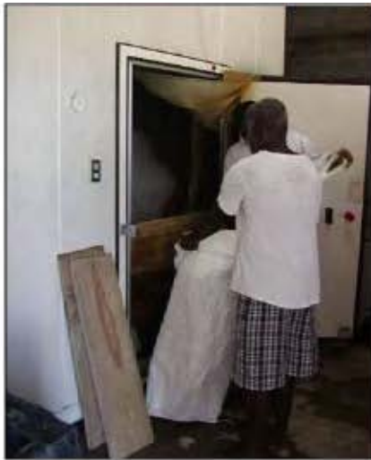
写真—5 既存貯氷庫 (木製パネルの腐食、水漏れ等、継ぎ目の剥離等の劣化が著しい。)
