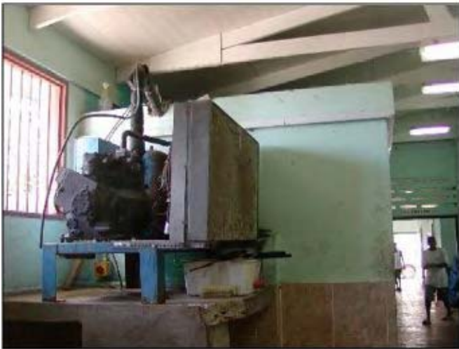
写真—25 魚市場内冷凍庫機械 （老朽化のため使用不能である。）
