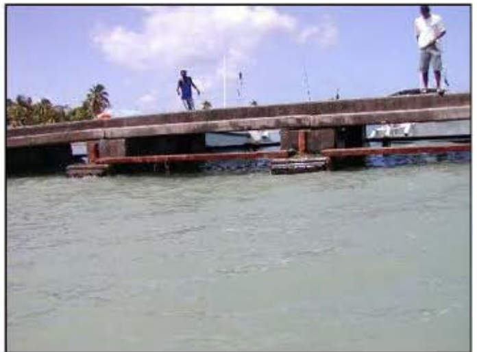
写真—8 水揚げ補助棧橋 (鋼製) (鋼製水揚げ補助棧橋には防舷材がなく危険である)
