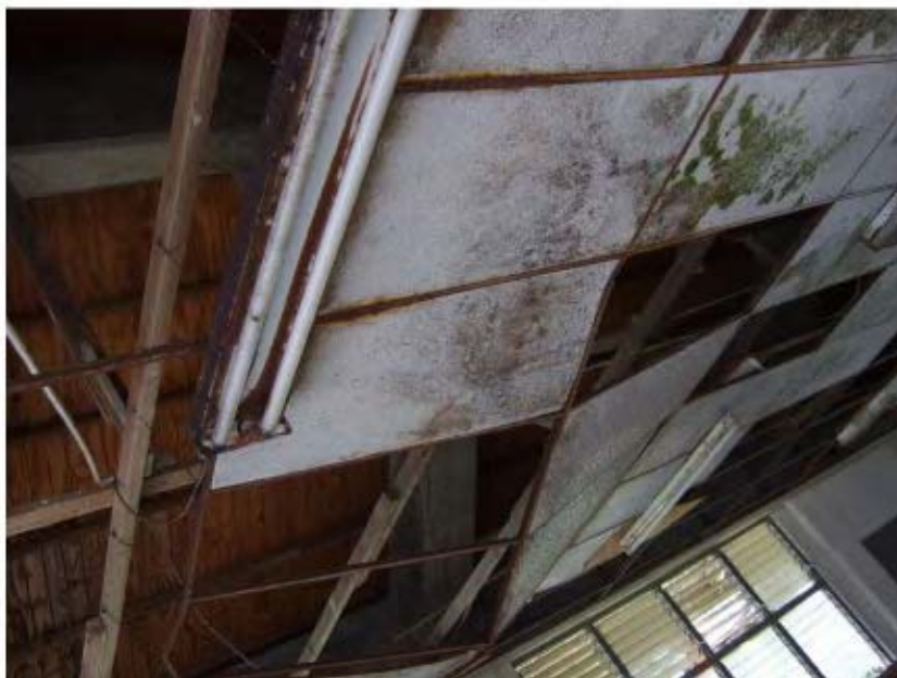
写真—4 既存水産センター内部被災状況
