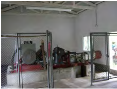
水車発電機器
