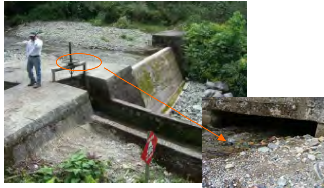
堰堤（取水口が堆砂でほとんど埋まっている）
