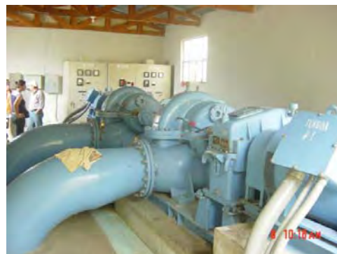
水車発電機器(日本製)
