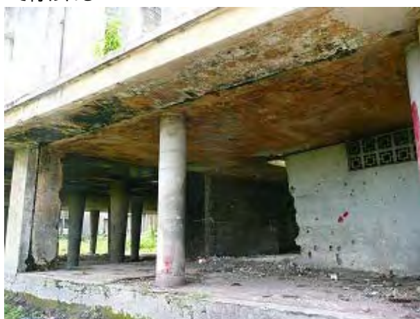
旧IEMキンシャサ校舎 壁や天井も崩れ落ちている部分が多い
