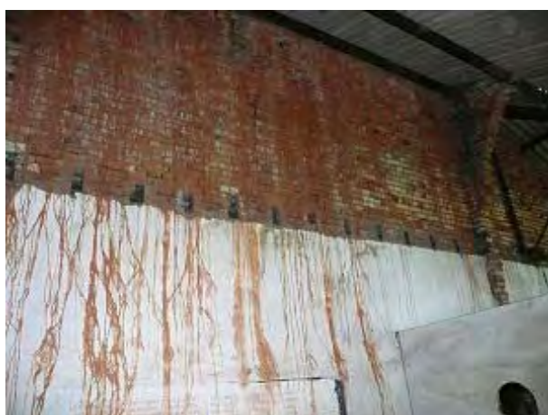
現IEMキンシャサ校舎内の壁 内部は動物舎として活用していた状態のままで汚れ が顕著、部屋数も少ないため講義が重なる場合は廊下 で行われる
