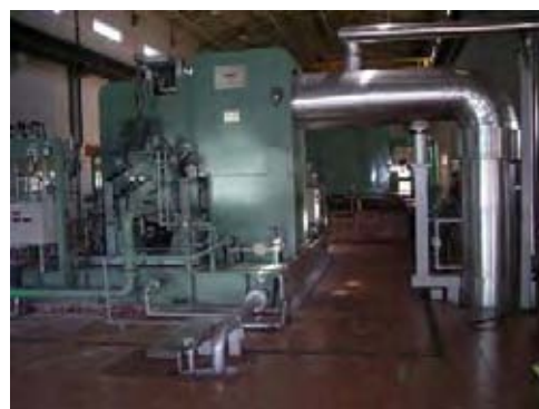
16 MW 蒸気タービン・発電機
