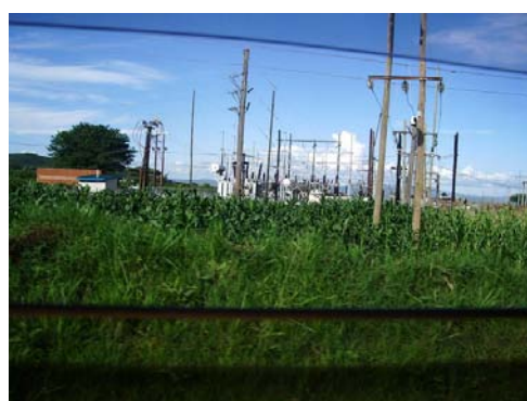
近傍の変電所
