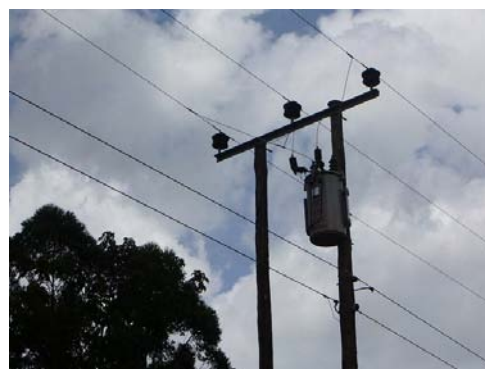
33 kV 送電線と 240 V 配電線
