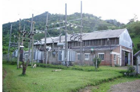
出力 5.4 MW(3×1.8 MW)
