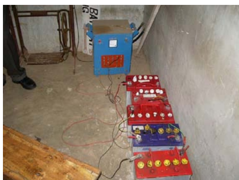
蓄電池充電料金 Ksh 30/回
