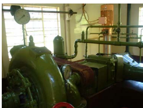
水車と発電機
