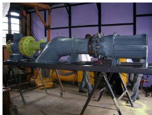
発電機(フランス製)と水車(右側)
