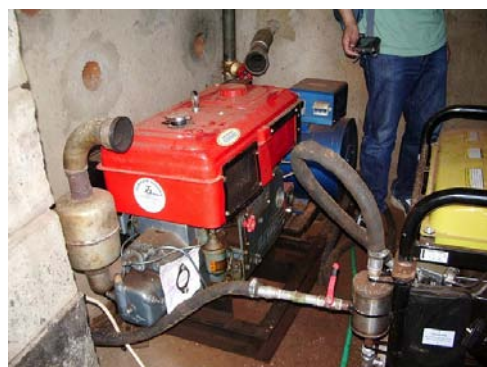
メタンガス使用の発電機(10 kW×2 台)
