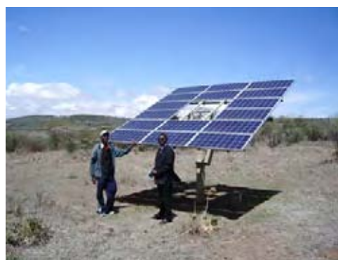
ロッジ電灯用パネル (1,280W・シャープ製)
