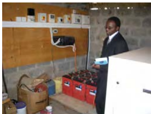
蓄電池 (350 Ah×12)・予備発電機(12.5 kVA)
