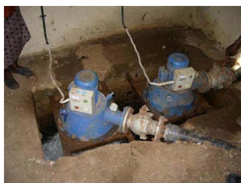
中国製水車発電機 (1 kW 2 台)
