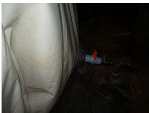
発生したメタンガスの貯留タンク(24m 3 )
