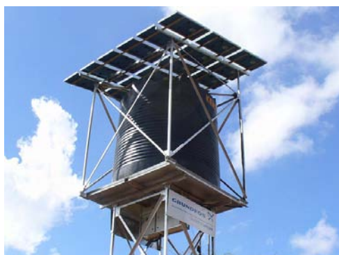
太陽光発電パネルと給水タンク
