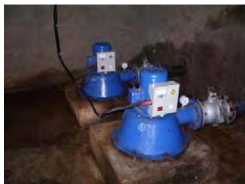
水車発電機(1 kW×2台・両岸住民へ配電)
