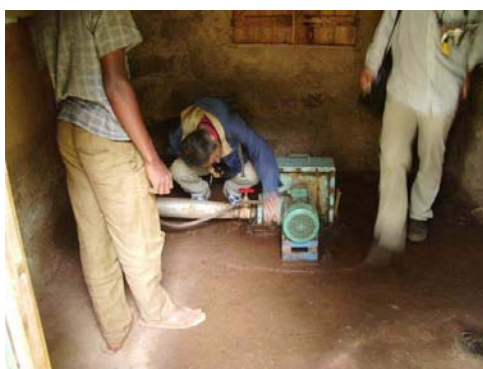
1.5 kW の水車発電機 (朝夕 2 時間発電)
