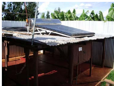
温度調節用太陽温水
