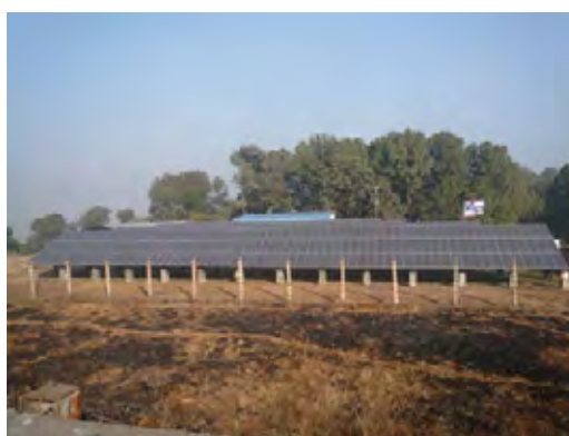
PV array (40kWp)
