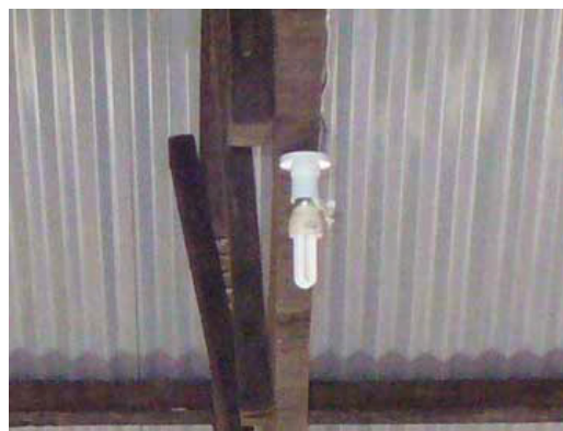
教室の天井に設置される照明の例
