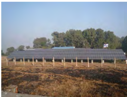
太陽電池アレー(40kWp)
