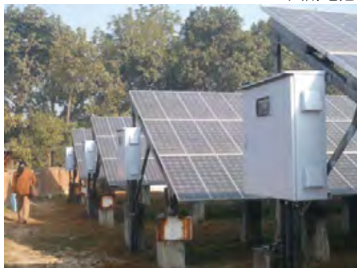
太陽電池サブアレー及び集電箱
