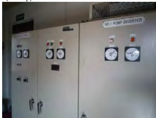
コントローラー及びインバーター盤
