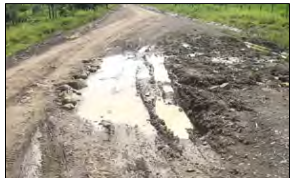
写真-12：「ア」街道は土道であり、凹凸が激しく、雨期の通行には非常な困難を伴う。「ア」街道の整備は IDB プロジェクトで実施されており、サンタフェ橋の供用に合わせて、竣工される予定である。
