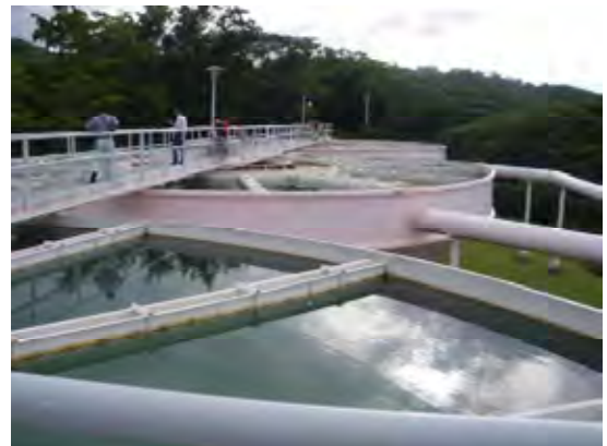
パイロット浄水場の高速凝集沈殿池 (Logwood)
