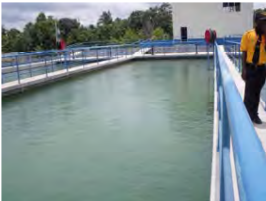
パイロット浄水場の凝集沈殿池 (Spanish Town)
