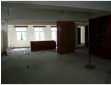
034 床の仕上げが相手国工事のため床に浮いたコンセント
