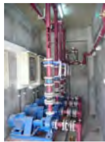
023 井水・雨水・揚水ポンプ
