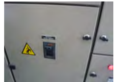
027 電機室 3(トランス)
