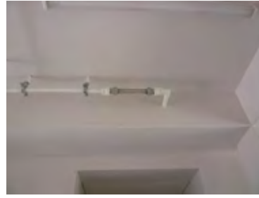
032 エキスパンションジョイント部分の給水管
