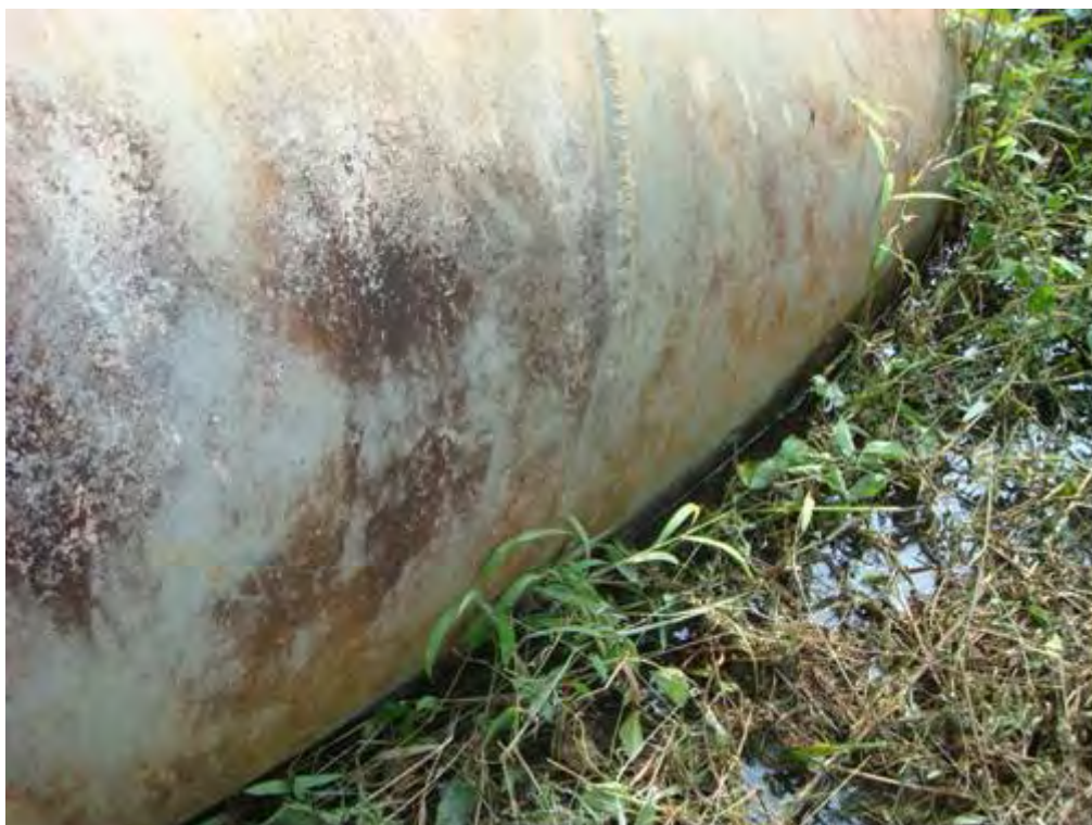
Photo 5.2-8 O'chum 2 発電所の水圧鉄管と固定台の接合部の水溜り
