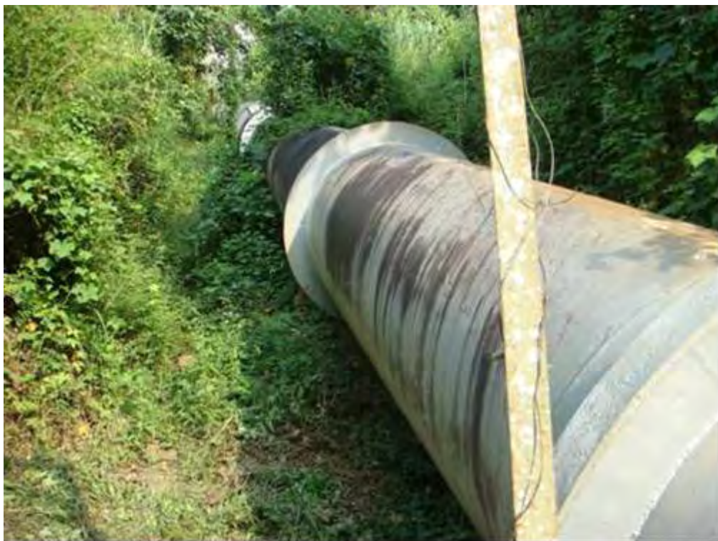
Photo 5.2-7 O'chum 2 発電所鉄管路
