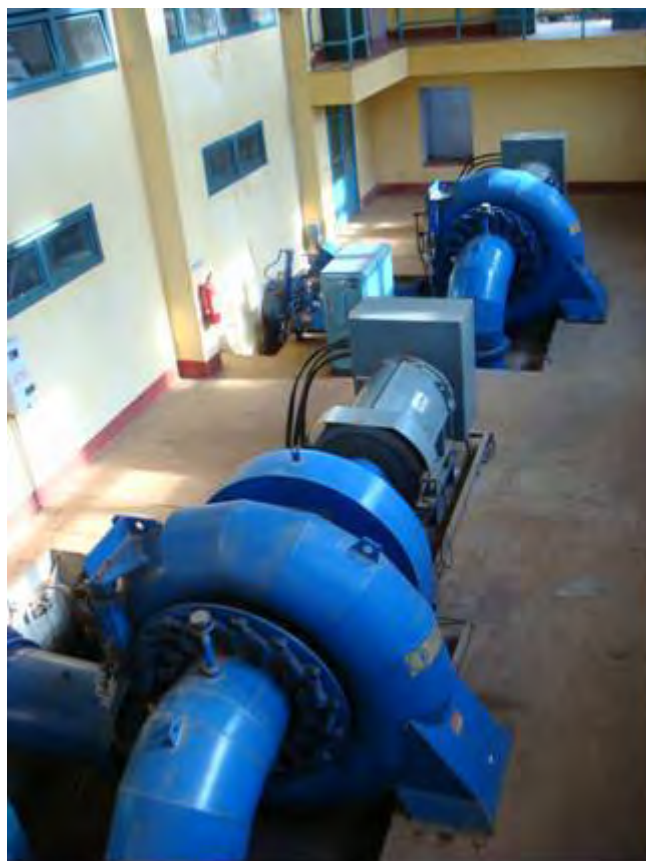
Photo 5.2-6 O'chum 2 発電所内部（水車発電機）
