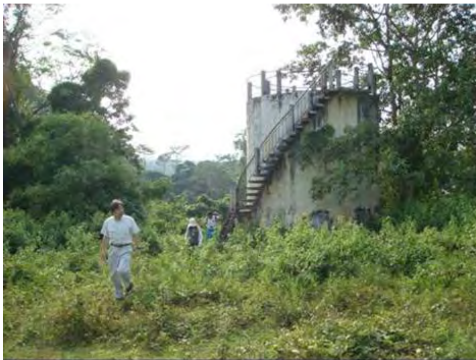
Photo 5.2-4 O'Chum 2 発電所のサージタンク
