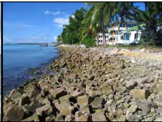
写真 4 - 32 政府庁舎裏の海岸の状況
