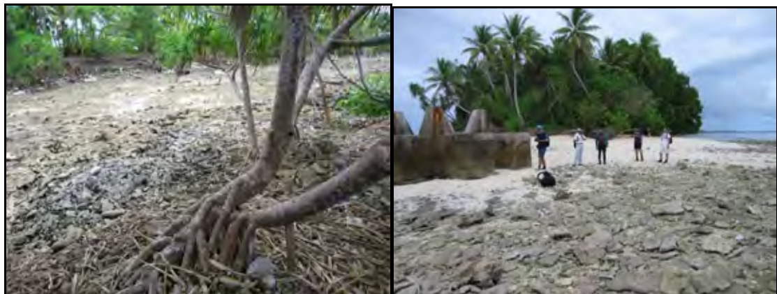
写真 4-3 越波による土採場への栗石の流入
