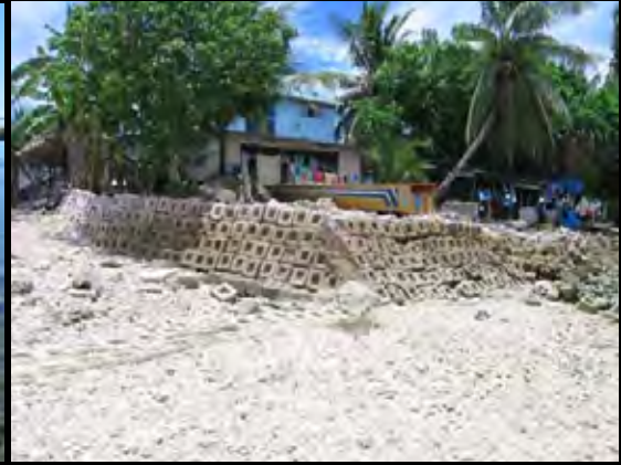
写真 4 - 36 初等学校裏の護岸の状況
