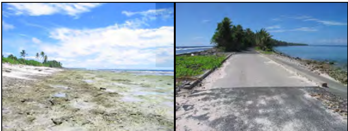
写真 4-9 滑走路北端部のリーフラットの状況
