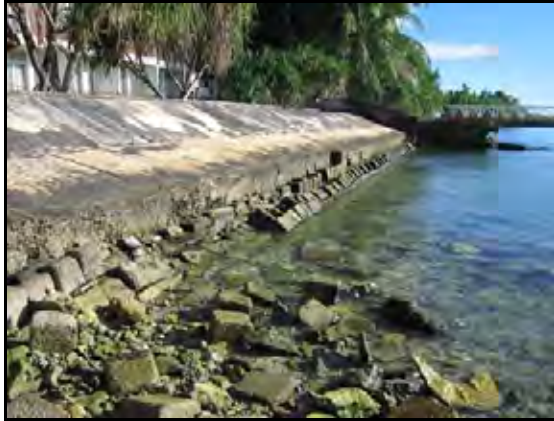
写真 4 - 35 ホテル裏の堤防の状況
