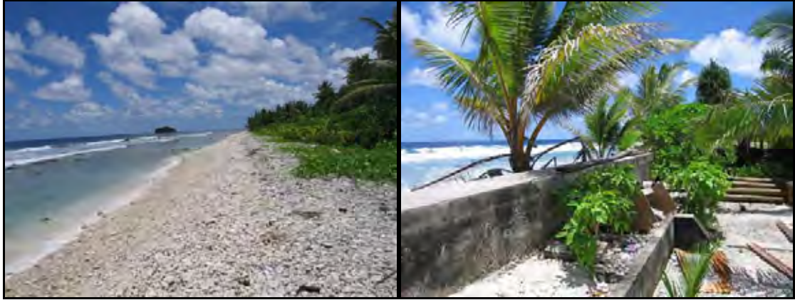
写真 4-15 南端部のストームリッジの状況
