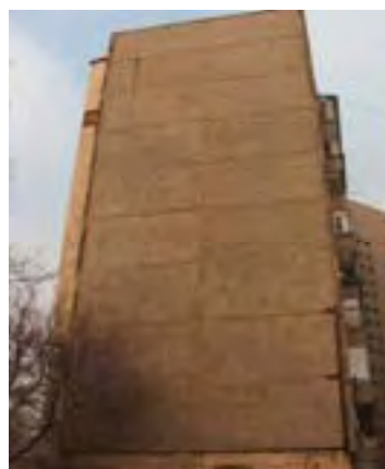
Рис. Zh-1/47. Жилое здание, ул. Торайгырова, 36
